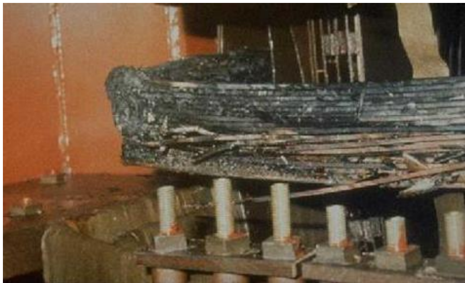
1989年の大磁気嵐で故障した アメリカの変圧器
