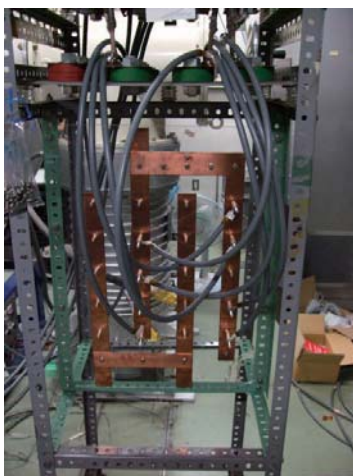
図8 製作した配電盤
