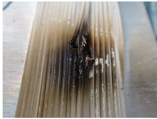
図2 放電による電力ハーネスの溶断
