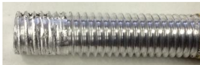
図 20 ダメージを受けた固定ボルト
