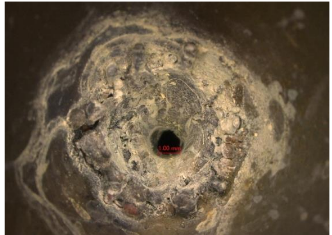
(c) アノードの損耗の様子ダイバージェント側
