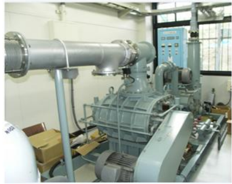
Fig.3-2 真空排気ポンプ
