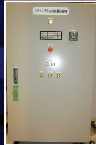
スティング式 支持装置制御盤
