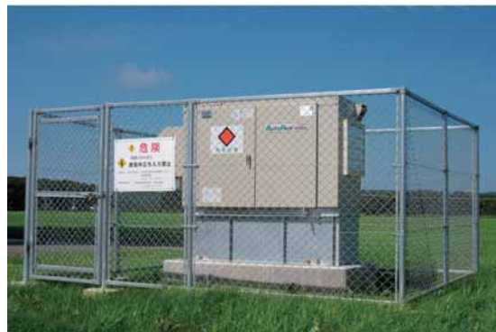
図 26(f) 非常用発動発電機
