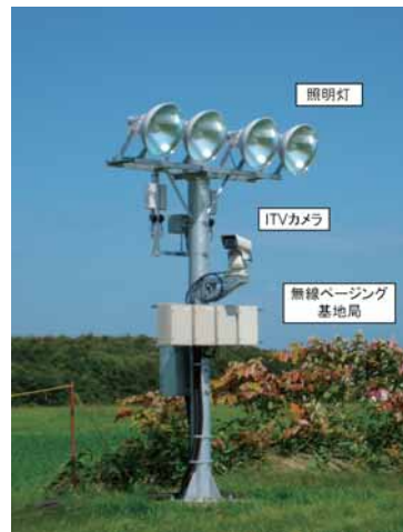
図 26(i) フィールド照明塔
