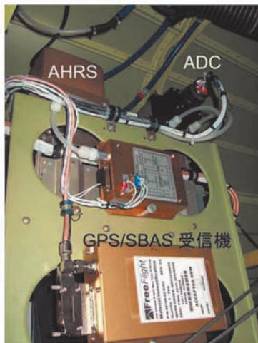
(1) ADC, AHRS, GPS/SBAS 受信機の装備 (後部アビオニクスラック)
