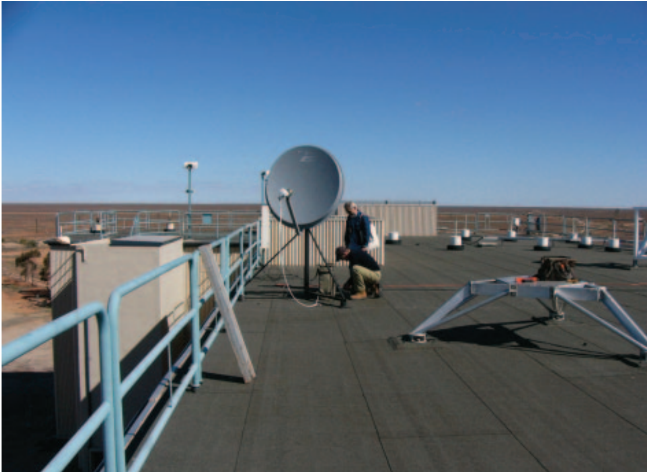
図3.5.8-5 インターネット用衛星通信アンテナ (IB屋上)
