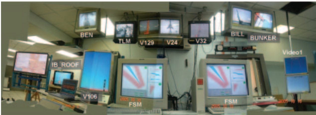
図3.9.4 RCC内の実際のカメラ配置の様子
