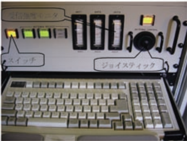
図3-7 手動アンテナ制御装置の外観
