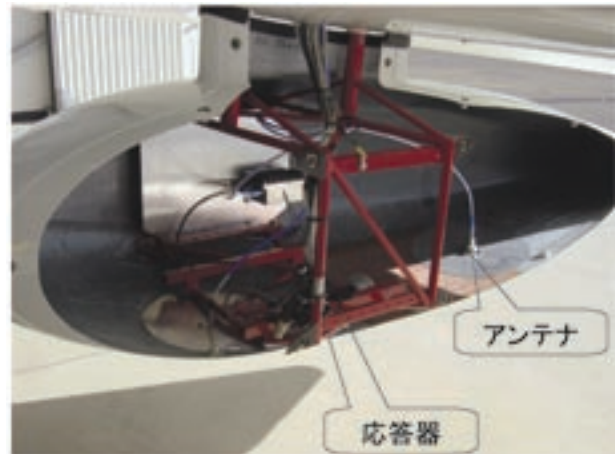
図A.2-5 トランスポンダ応答装置とアンテナの実装外観
