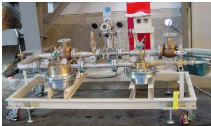
図 A1-10 ヘリウム供給装置(減圧ユニット)
