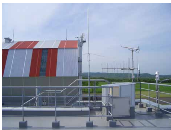
図 A4.3-4(2/2) モニタ用アンテナ(管制用屋上)
