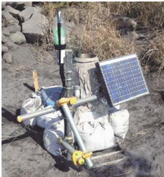
図-3 機器設置状況
