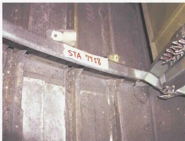
図32. FSTA-7758荷物室右フレームの座屈状況 (前方より)
