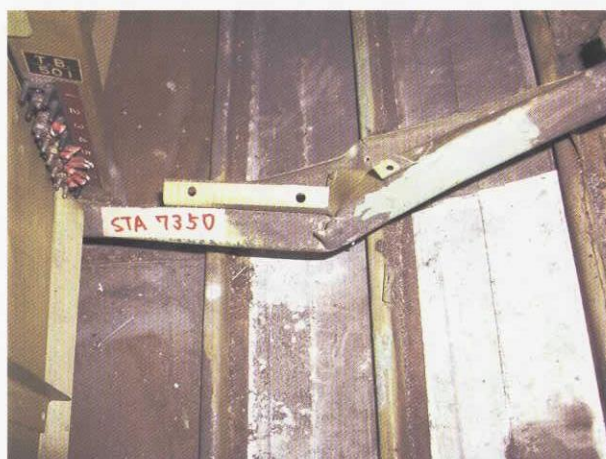
図33. FSTA-7350荷物室左フレームの座屈状況 (前方より)
