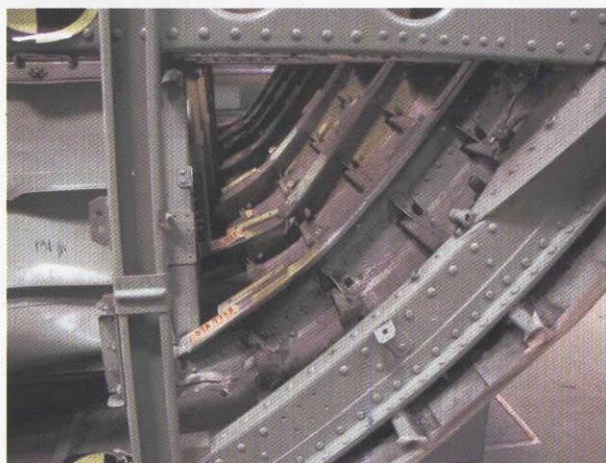
図27. 荷物室左側フレームの座屈状況（前方より）
