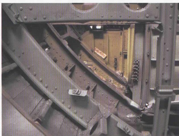
図28. 荷物室右側フレームの座屈状況（前方より）
