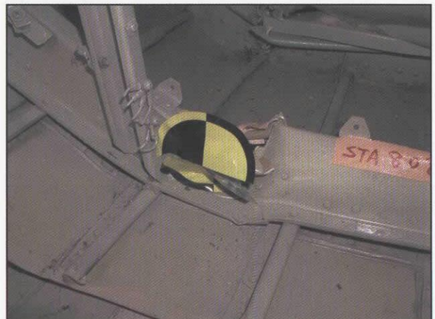
図40. FSTA-8080フレーム右下の座屈状況(前方よ
