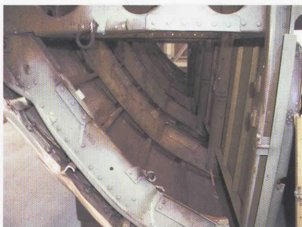
図29. 荷物室左側フレームの座屈状況 (後方より)
