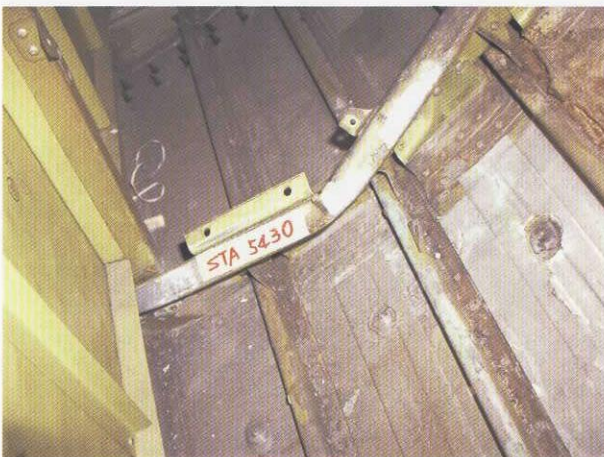
図37. FSTA-5430荷物室左フレームの座屈状況(前方より)
