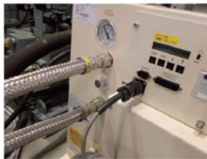
図 5.5 圧縮機に接続されたフレキシブルチューブとモーターケーブル
