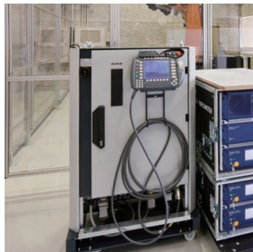
Fig.3.8 ロボット制御装置とティーチペンダント KCP
