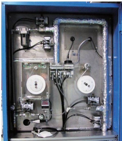
図 9 温度管理された配管
