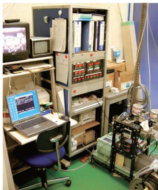
図41 高圧セクタ実験棟制御室
