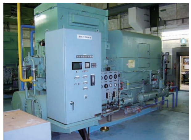
図6 連続ラム燃焼試験用空気圧縮機C号機
