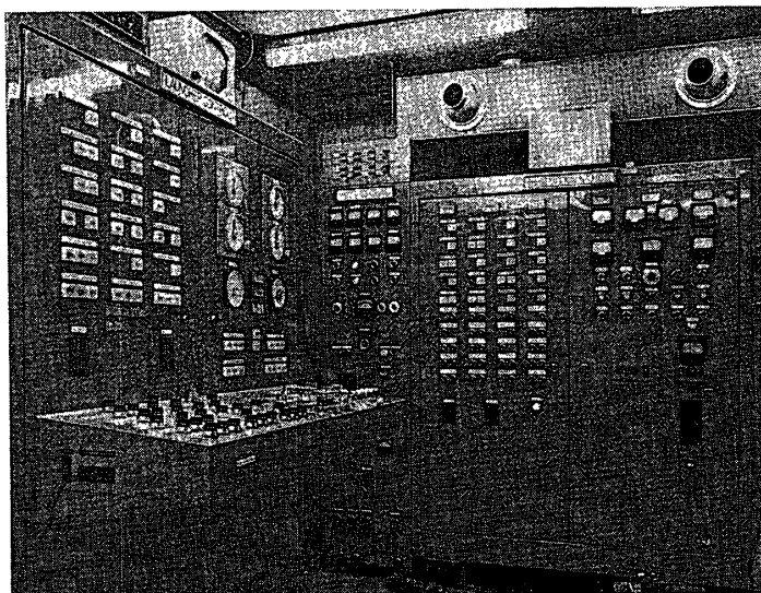
第 2 図 機上点火系管制盤
