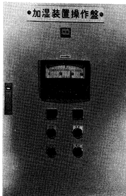
第7図 加湿装置の制御盤
