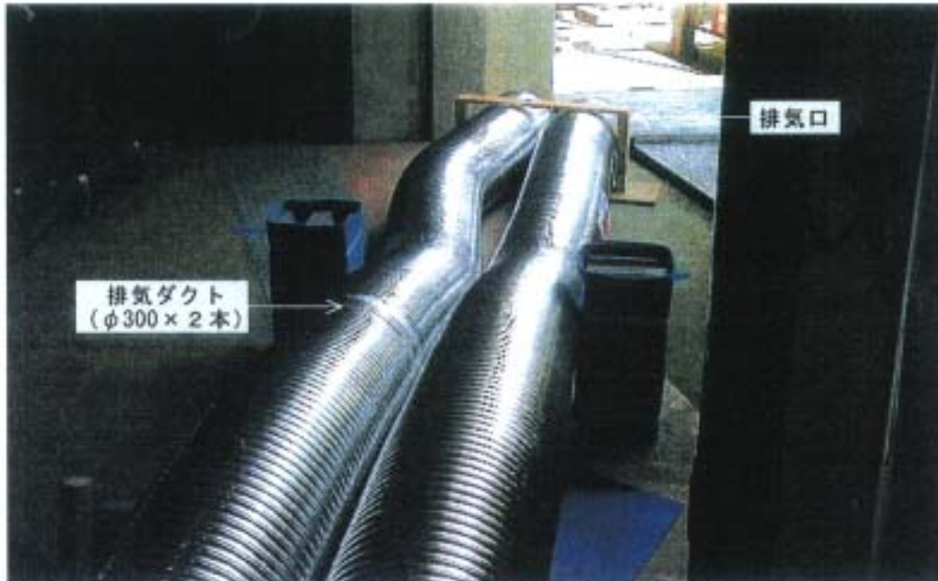
写真2-5 排気ガスの外部放出ダクト
