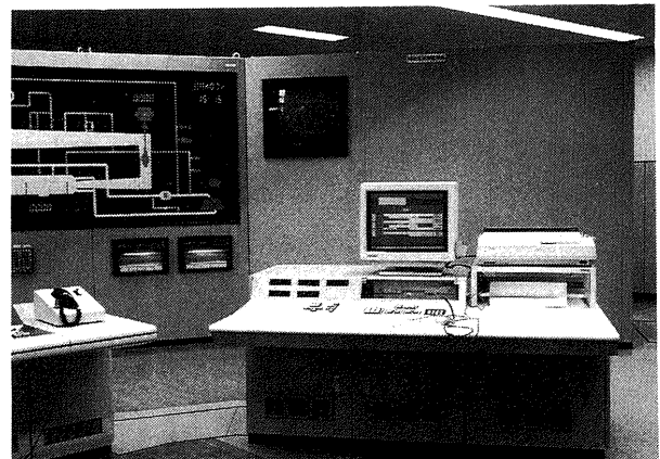
図5.1 補助送風機監視盤・操作盤
