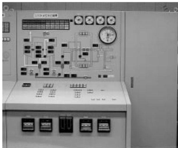
図4.1 中央操作監視盤
