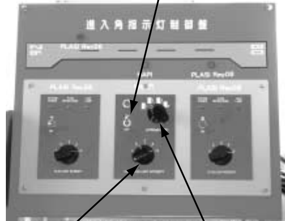
図 2.5 大樹町実験棟に設置されたHAPI/PLASI制御盤
