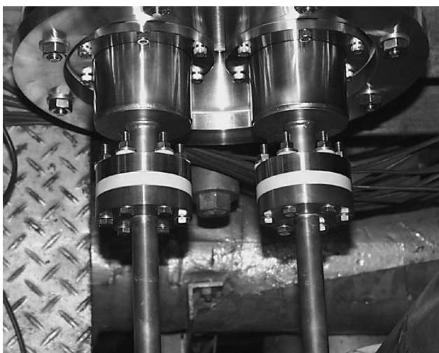
図10 フランジ継手の外観
