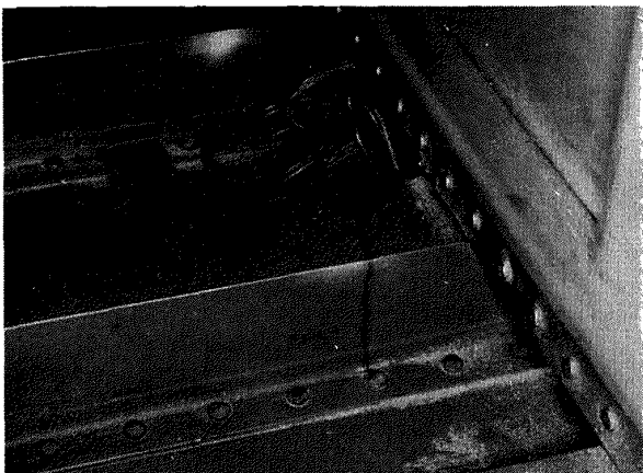
図 13 Saw cut A-1 のき裂
