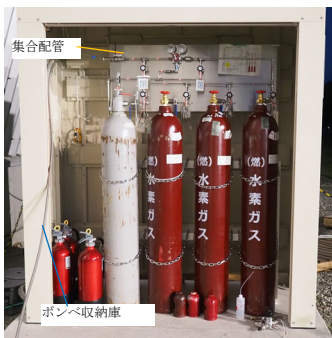
図 2. ボンベ収納庫
