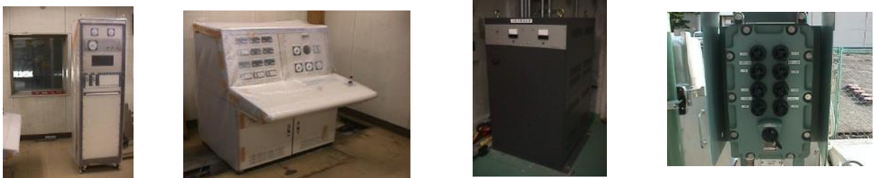
図 3-2 YJ69 運転用器材(計測盤、運転盤、始動用電源、燃料ポンプ操作盤)
