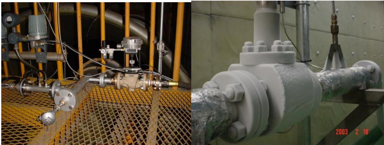
図 3-10 圧縮機抽気流量計および流量調整バルブ、空気冷却用流量調整弁
