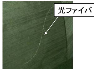
光ファイバ貼り付け部分
