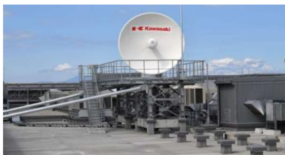
Ground Station (Gifu Plant KHI) 地上局（川崎重工工業岐阜工場内）
