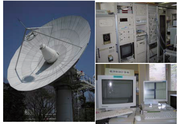
図3 NICT 小金井本部の受信設備
