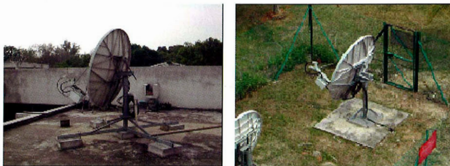
写真：点検整備対象のVSAT局設備（左：AIT設置のVSAT 右：MMU設置のVSAT）
